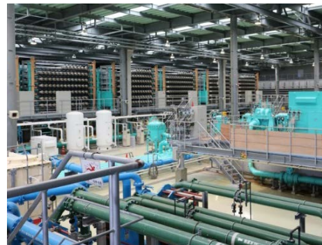
海水淡水化センター施設内
