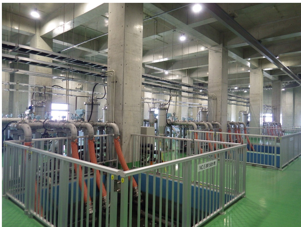
東隈浄水場（膜ろ過設備）
