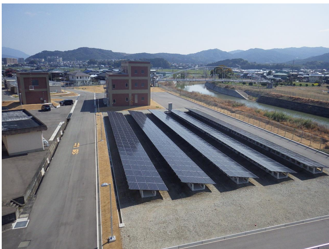
東隈浄水場（太陽光発電設備）
