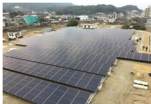
太陽光発電設備
